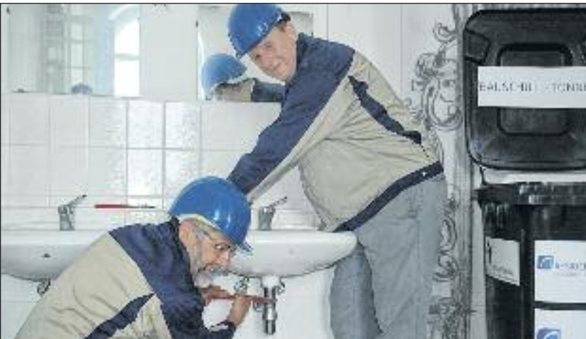
Landrat Dr. Christoph Scheurer (r.) und Bürgermeister Bernd Pohlers gaben mit der Demontage von Waschbecken den offiziellen Startschuss zum Innenausbau des Schlosses.
