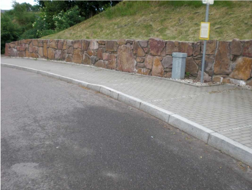
Abbildung 26: Beispiel für nicht bus- und fahrgastgerechten Haltestellenausbau (Gefährdungspotential für Fahrgäste beim Kneeling, Beschädigungsrisiko für Busse beim Anfahren der Bordsteinkante, Bordhöhe nicht niederflurgerecht)
